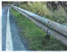
木製ガードレール
